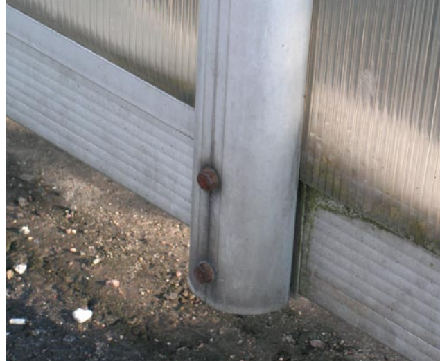
Wygląd łączników ocynkowanych w konstrukcji aluminiowej po 4 latach
